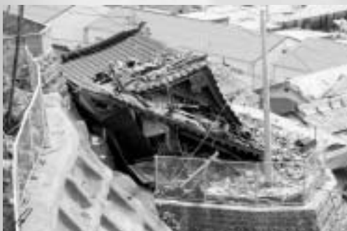
福岡県西方沖地震「揺れによって完全倒壊した伝統工法の建物」 (写真提供:川口助教授)
